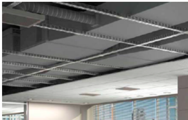
Figura 3 - Sistema de renovação e filtragem de ar.
