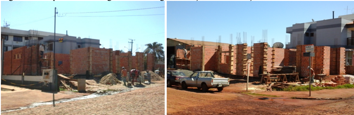
Figura 10. Sequência de fotografias de estágios avançados da elevação da alvenaria da Obra 05.
