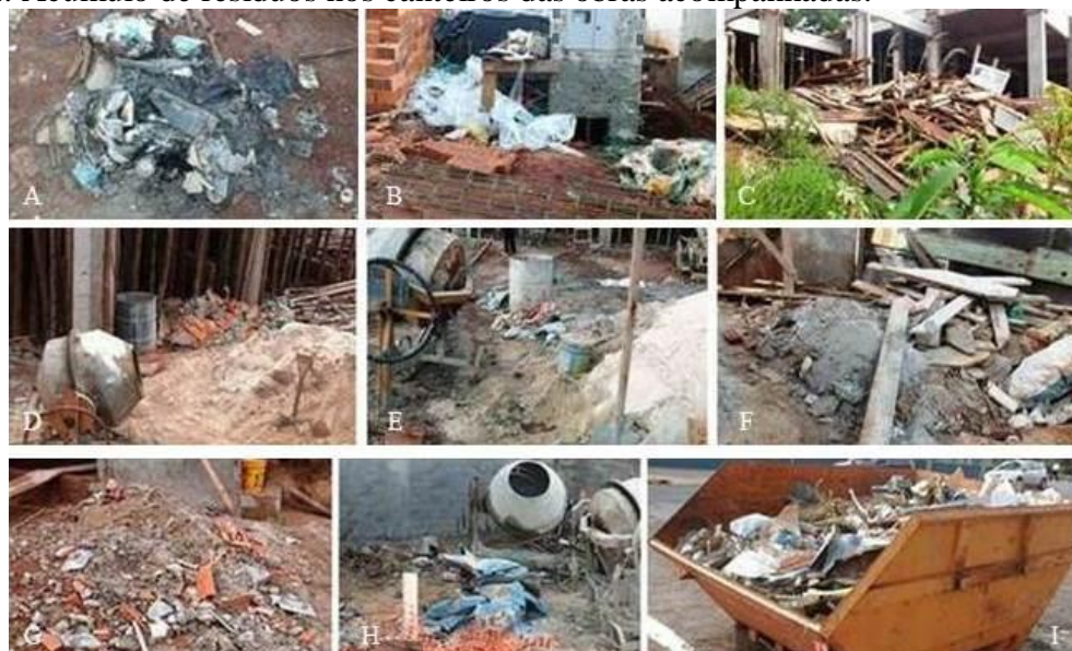
Figura 2. Acúmulo de resíduos nos canteiros das obras acompanhadas.
