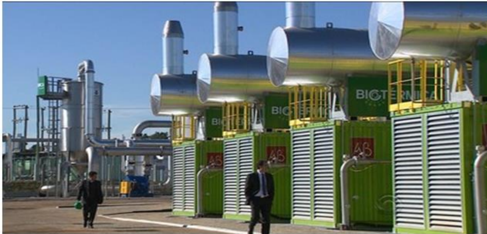
Figura 5: Usina de biogás inaugurada em 2015
