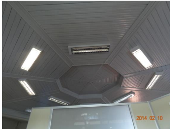
Figura 6 - Análise do sistema de iluminação com ausência de manutenção na Secretaria de Obras, Habitação, Urbanismo e Meio Ambiente que está situada no Palácio Plácido de Castro. Fonte: Autor.
