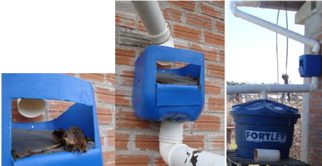
Figura 4- Filtro instalado após as chuvas.
