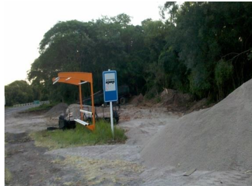
Ilustração 18 – Canteiro de obras: material disposto diretamente em contato com o solo Fonte: Registro dos autores
