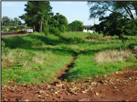
Ilustração 11 – Drenagem pluvial vindo do outro ponto contaminado
